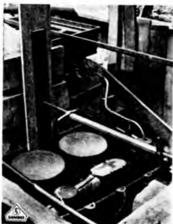
Abb. 24. 30 kV-Drehstrom-Ölkabelmuffe mit Ausdehnungsgefäßen.
