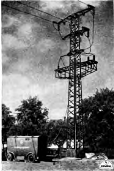
Abb. 18. 66 kV-Drehstrom-Ölkabel. Übergang auf Freileitung.
