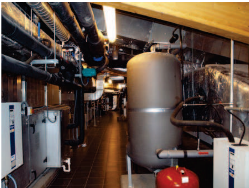
Urządzenia klimatyzacyjno-wentylacyjne – III p.
