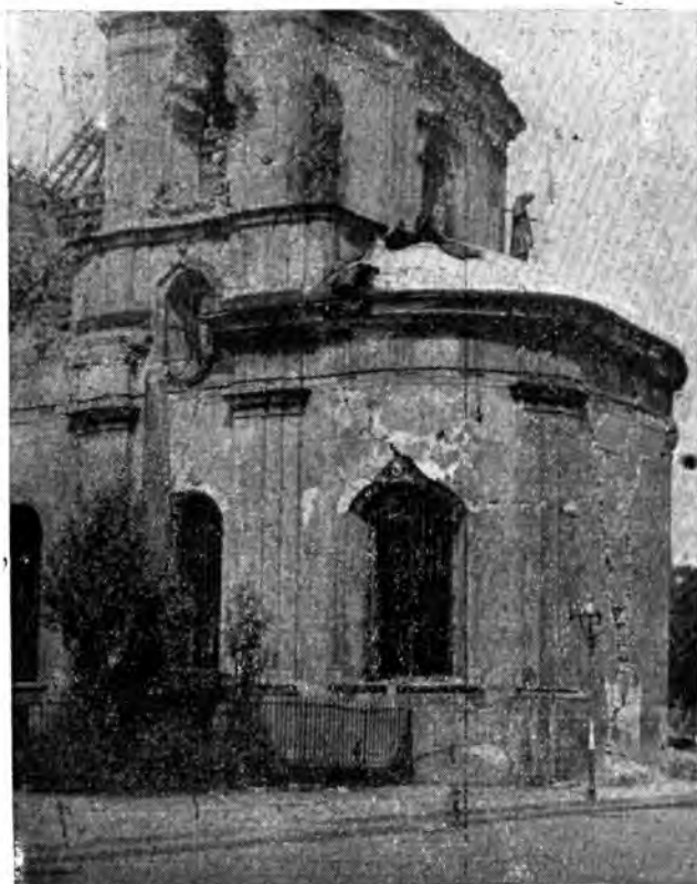
Fig. 9. Kaplica Mariacka z XVIII wieku przy kościele Św. Wincentego we Wrocławiu o pięknej barokowej dekoracji wnętrza. Na zdjęciu widoczny jest groźny stan murów. Mury zostały zabezpieczone specjalną drewnianą konstrukcją a następnie partiami przebudowane od fundamentów. W ten sposób uratowano kopułę i wnętrze.
