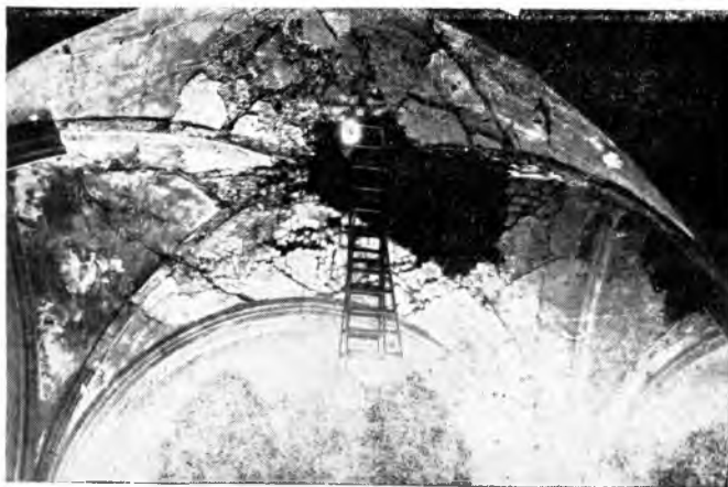
Fig. 39. Jedno ze zniszczonych sklepień zabytkowego starożytnego Ratusza we Wrocławiu.
