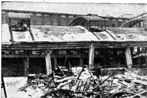
Fig. 1. Widok boczny zniszczonej hali.
