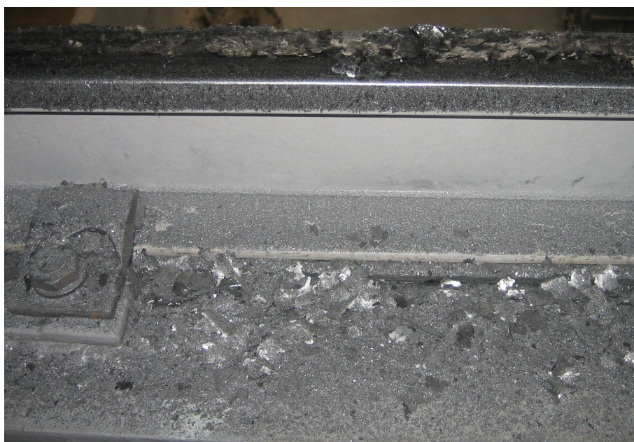
Fot. 6.3. Zniszczenie szyny
