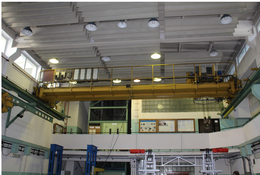
Fot. 5.2. Stanowisko do badań ruchów skojarzonych-suwnica
