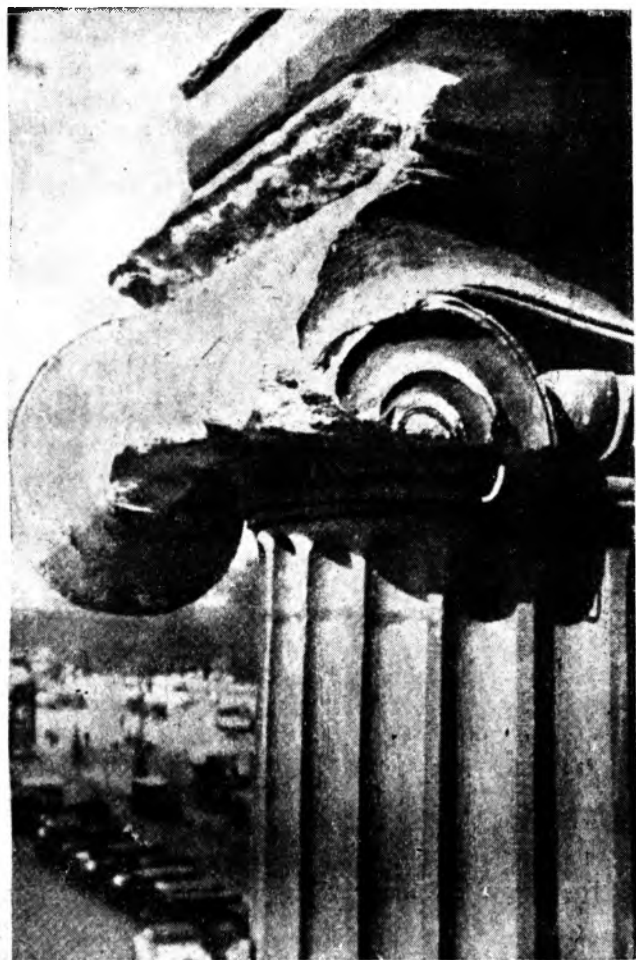
Fig. 1. Kapitel jednej z kolumn Banku Handlowego w Kopenhadze uszkodzony przez zwietrzenie kamienia.
