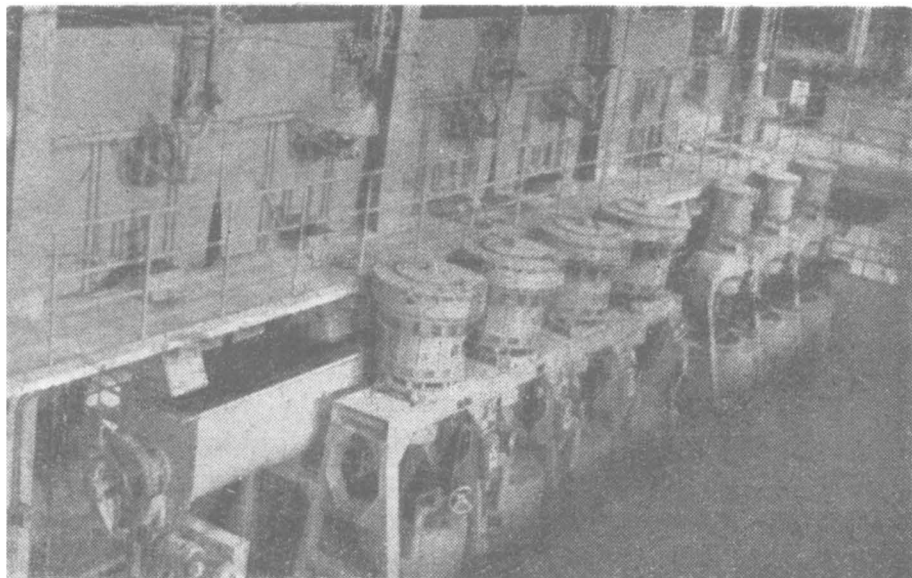
Stacja mieszadeł i wirówek
