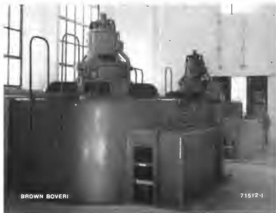
Abb. 3 — Zwei Drehstromgeneratoren mit Umlaufwasserkühlung von 5200 kVA, 3300 V, 1000 U/min in der Zentrale Cedros (Brasilien), welche ausschliesslich mit elektrischem Material von Brown Boveri ausgerüstet ist
