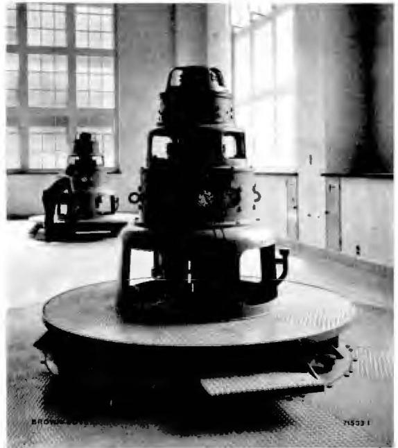
Abb. 10 — Maschinensaal des neuen Kraftwerkes Wassen (Schweiz) Die beiden Dreiphasengeneratoren von 30 000 kVA, 12 000 V, 50 Hz, 750 U/min sind versenkt aufgestellt, einzig Haupt- und Hilfsregler ragen in den Maschinensaal hinein.
