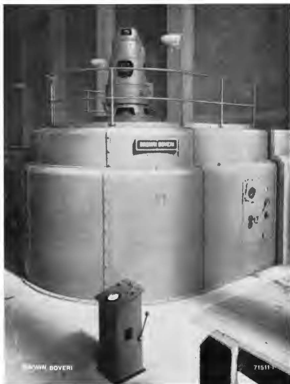
Abb. 4 — Einer der beiden 15 500-kVA-Generatoren, 750 U/min, der Zentrale Las Conchas der „Fenosa“ (Spanien)
