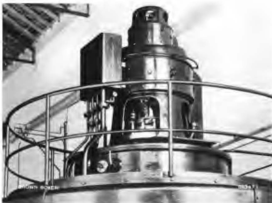
Abb. 2 — Oberer Teil eines vertikalachsigen Drehstromgenerators von 17 500 kVA, 600 U/min, 6 kV in der Zentrale Lindoso der Soc. Electra del Lima (Portugal)
