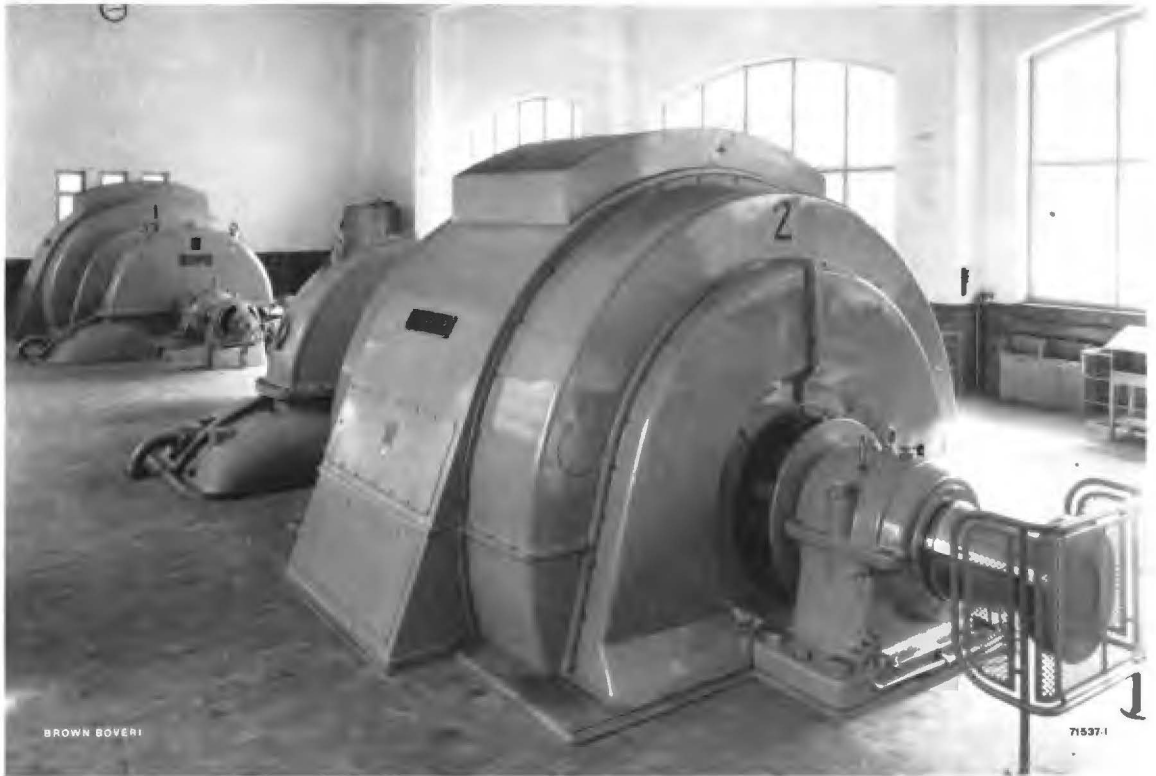
Abb. 11 — Zentrale Airolo des Kraftwerkes Lucendro mit zwei Dreiphasengeneratoren von 30 000 kVA, 11 000 V, 50 Hz, 500 U/min
