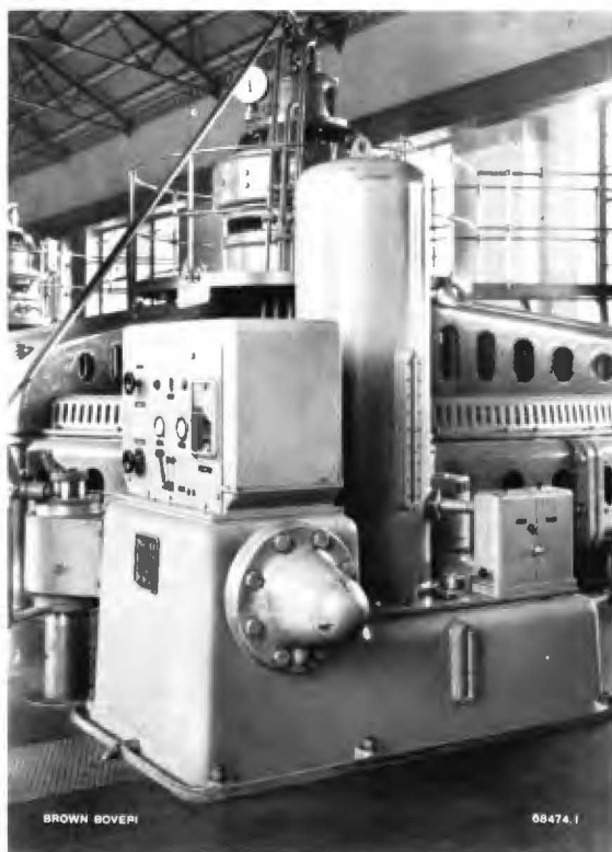
Abb. 1 — Turbinenregler mit elektrischem Drehzahlreglerkopf zu einer Kaplan turbine von 2250 PS bei 107 U/min
