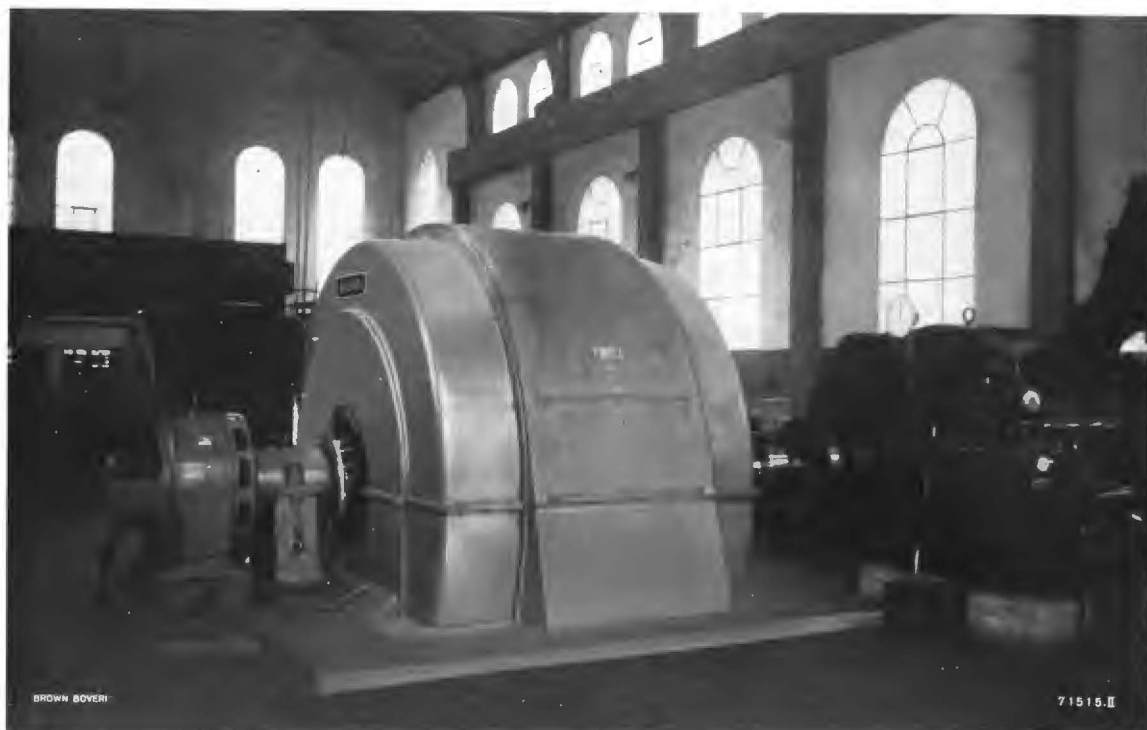
Abb. 7 — Einer der beiden Dreiphasengeneratoren von 9500 kVA, 500 U/min, 6600\text{ V} \pm 9\% in der Zentrale Peña de Bejo der Sociedad Saltos del Nansa (Spanien)
