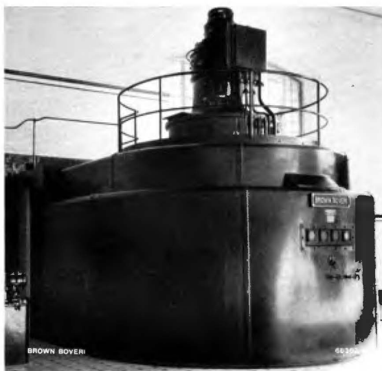
Abb. 1 — Vertikalachsiger Drehstromgenerator von 17 500 kVA, 600 U/min, 6000 V, 50 Hz in der Zentrale Lindoso der Soc. Electra del Lima (Portugal)
