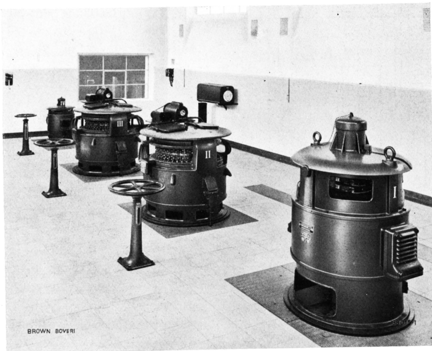
Abb. 1. — Innenansicht des Pumpwerkes Giessliweg, Basel. In der Mitte zwei Dreiphasen-Nebenschluss-Kommutatormotoren mit selbsttätiger Drehzahlregelung.
